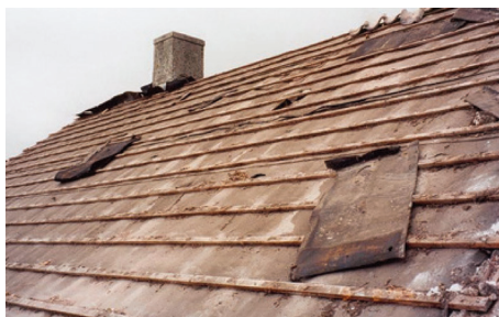
Zborcení konstrukce budovy působením hub a plísní
