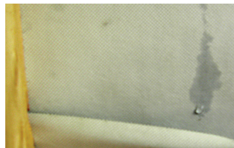
Poškození stěn v interiéru po vniknutí vody
